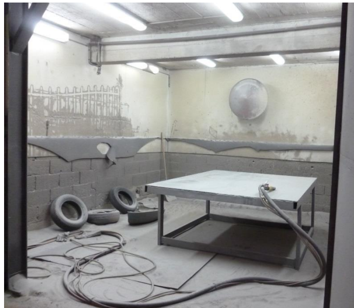
Photo 3 : Cabine de décapage minéral. La poussière est aspirée par le dépoussiéreur (sur le mur en face), mais les résidus de silicates tombent sur le sol et sont ramassés à la fin de chaque journée de travail. Cette cabine sera prochainement supprimée et remplacée par une cabine pour le corindonage.
