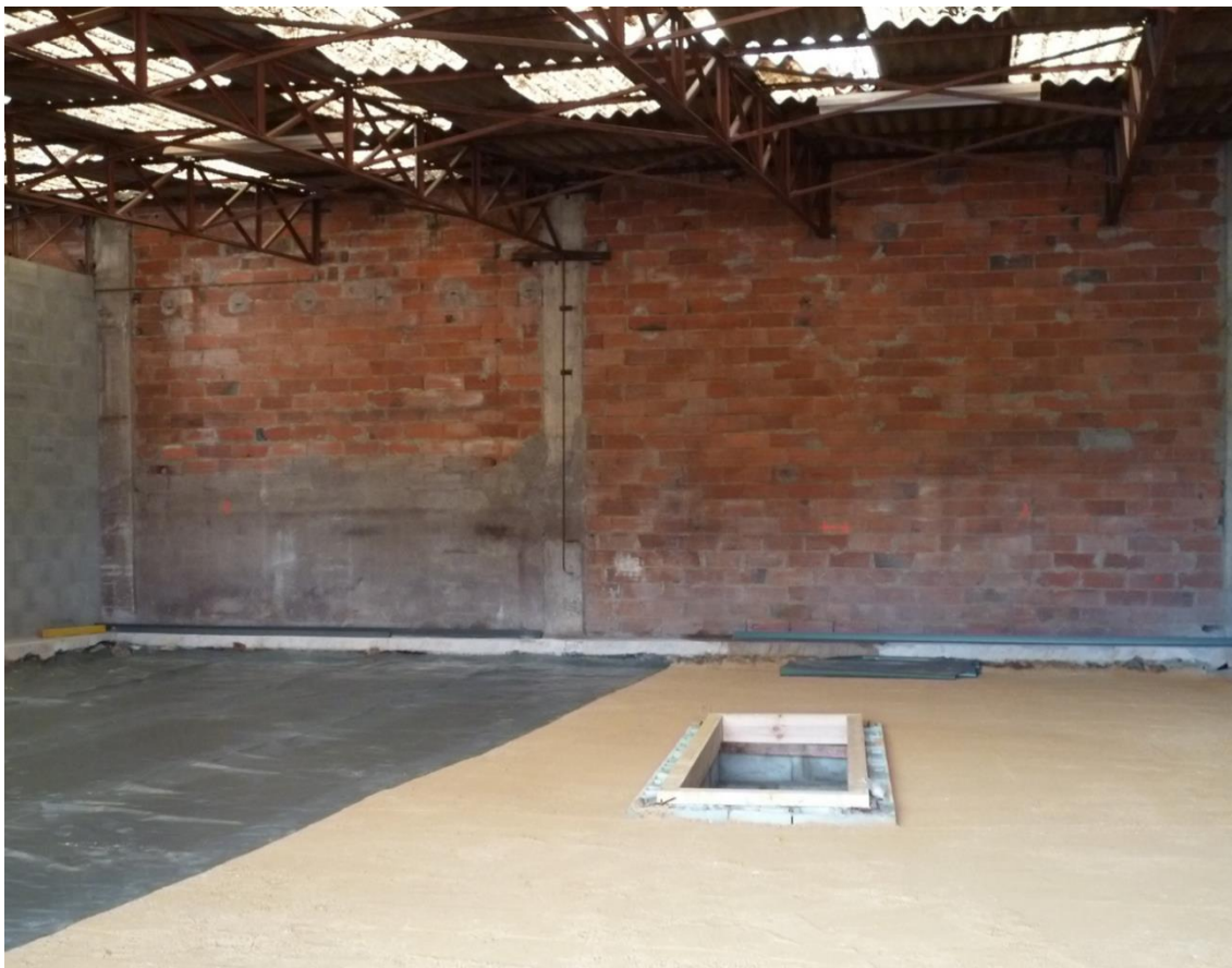
Photo 15 : Travaux d'étanchéification du sol de la pièce où seront entreposés les solvants et les cuves
