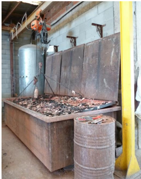
Photo 12 : Cuve de solvant. Le tamis récupérant les résidus de peinture qui se détachent est remonté. La cuve grise au fond est une seconde cuve d'air comprimé.
