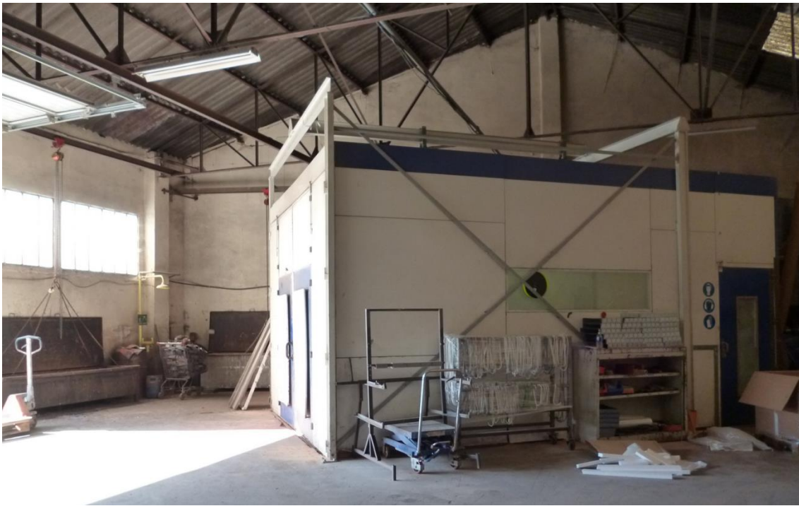
Photo 4 : Cabine de décapage végétal. L'enceinte de cette cabine va être changée afin de mieux l'insonoriser. Au fond à gauche, on distingue 2 cuves de solvant et une douche pour les yeux.
