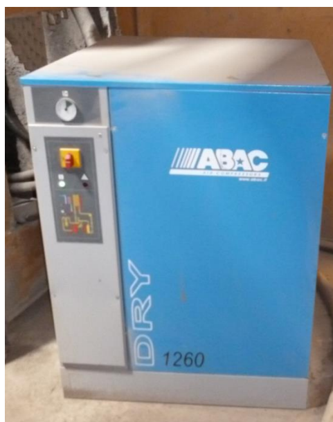
Photo 9 : Second compresseur, plus récent (à gauche) avec sécheur d'air (à droite)
