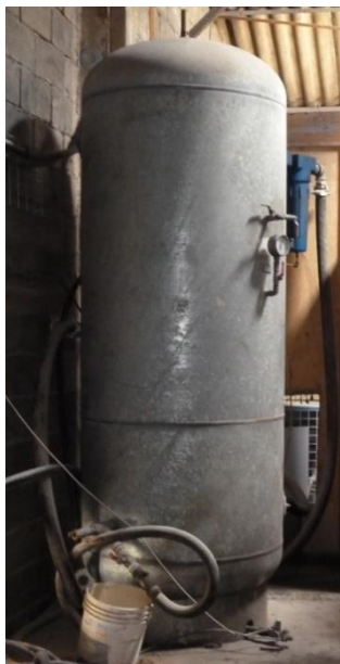
Photo 10 : Cuve d'air comprimé
