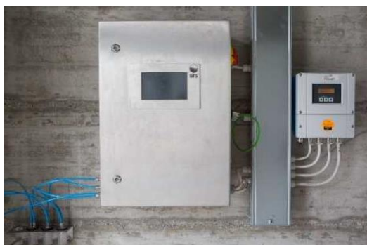
Figure 70 : Baie d'analyse du Biogaz
