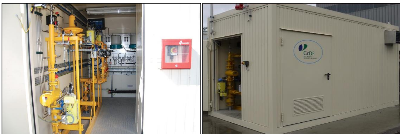
Figure 16 : Poste d'injection de biométhane dans le réseau GrDF
