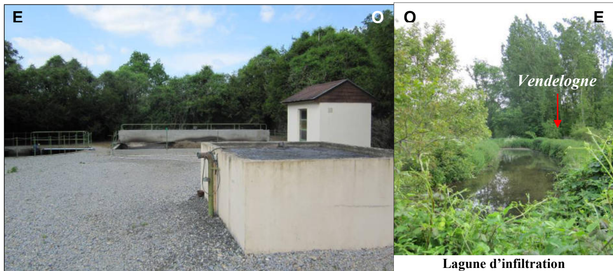
Figure 44 : station d'épuration du bourg d'Ayron : traitement par boues activées avec lagune d'infiltration en bordure de Vendelogne (22/05/2012)
