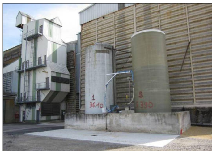
Figure 33 : cuves d'azotes avec plateforme de chargement
