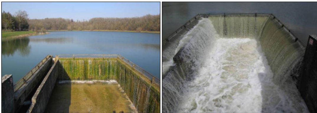
Figure 37 : surverse en aval du plan d'eau d'Ayron 16/03/12 et le 29/04/12 (Vendelogne en crue)
