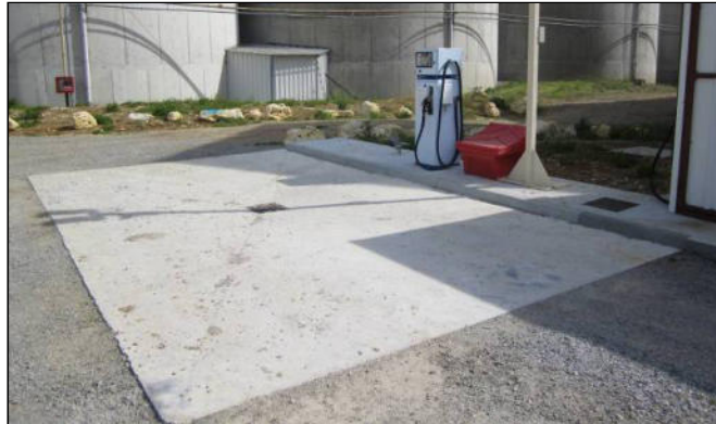
Figure 34 : plateforme de remplissage d'hydrocarbures avec bac de rétention
